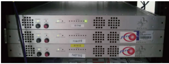
图 2 FAST数据采集终端ROACH2 Fig. 2 Terminal of FAST: ROACH2
